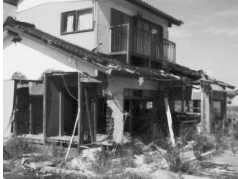
図 14 被災した住宅
