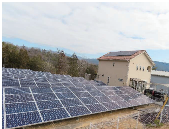
写真1 宅地に隣接した発電用パネル
