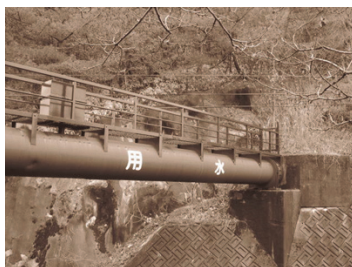
図7 用水取り入れ口の配管
