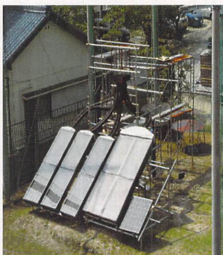
写真-1 システム全景
