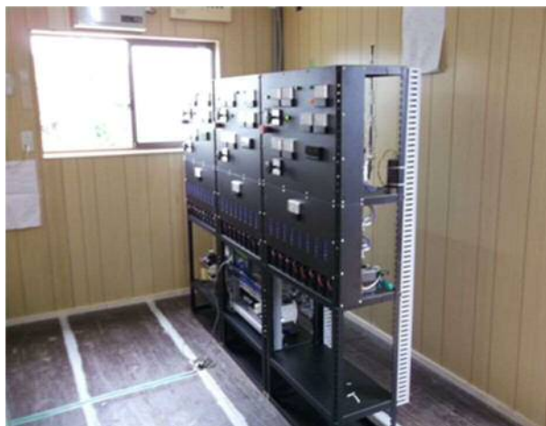
図4：風車のコントロールパネル(コントローラ)
