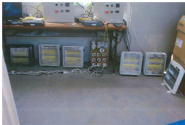
写真 3 B 風車および C 風車の電熱器負荷写真
